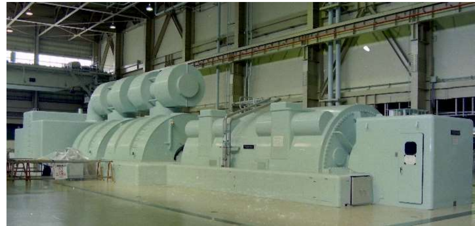
タービン発電機（タービン建物3階）
