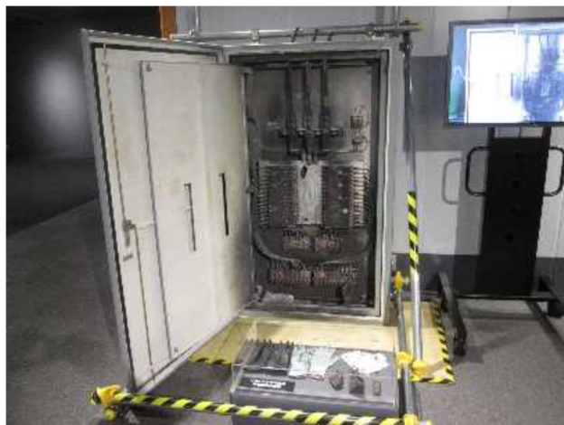
柏崎5号炉 定検用分電盤火災
