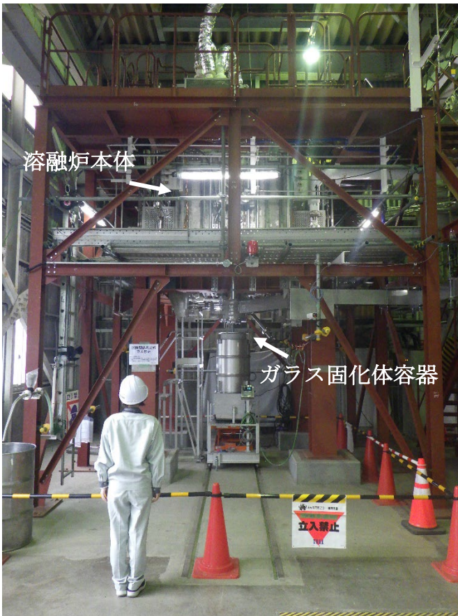
写真-1 3号熔融炉設置状況
