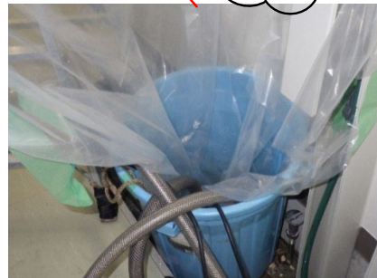
雨水の集水状況
