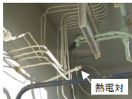
温度警報装置 (熱電対：屋外) HASWS-02-写 03
