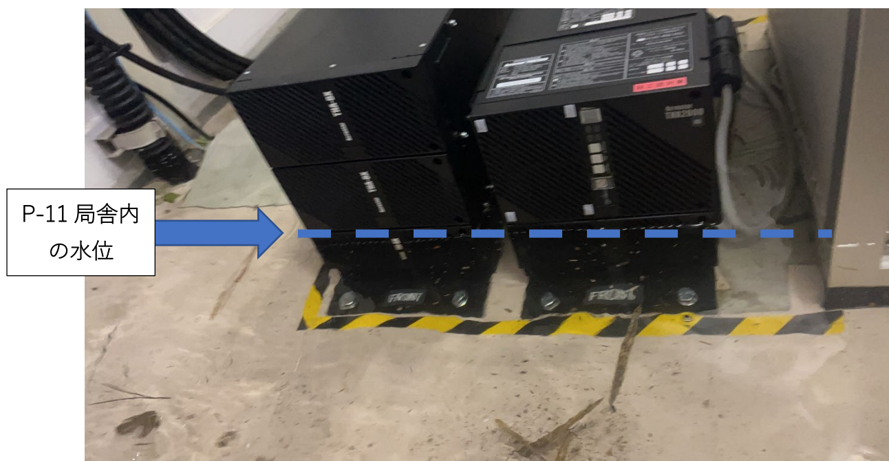
P-11 局舎内の浸水状況
