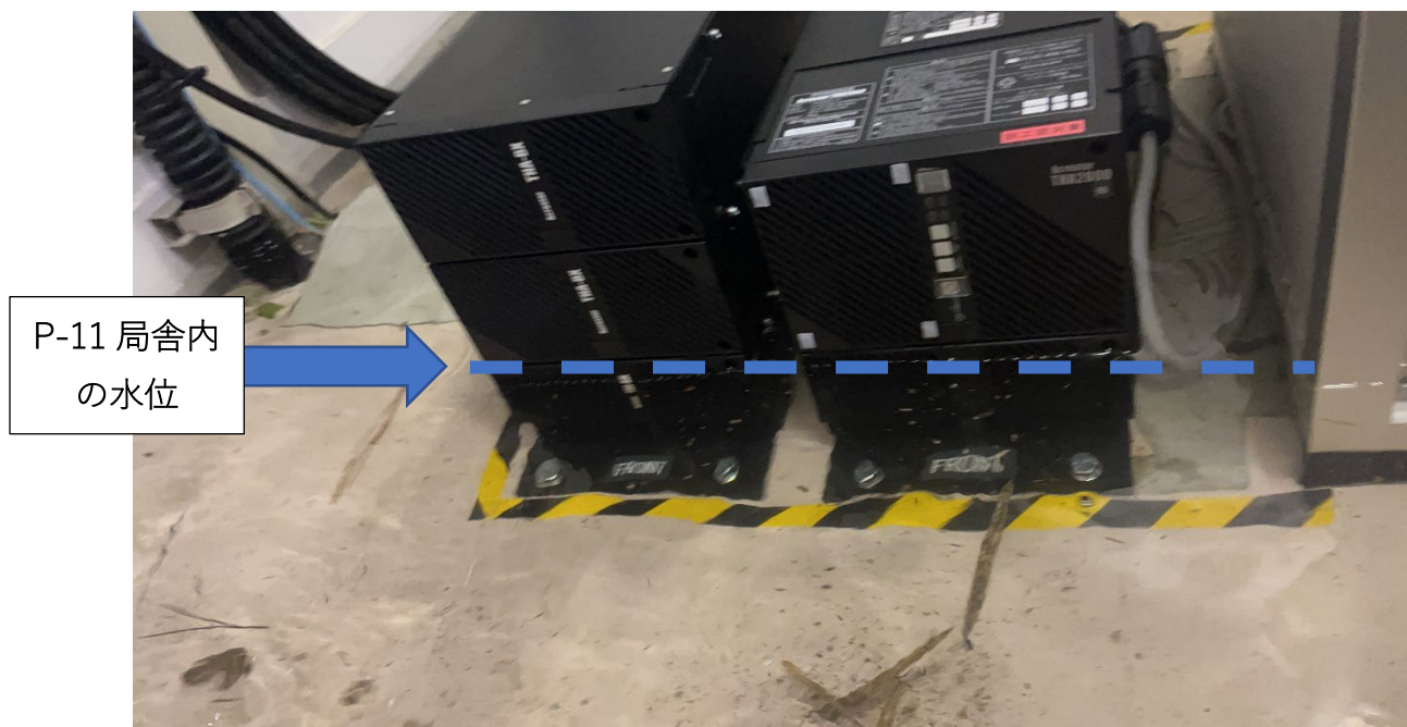
P-11 局舎内の浸水状況
