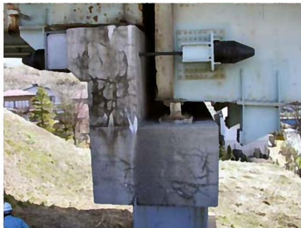
実構造物における膨張ひび割れ（亀甲状）の事例 2)
