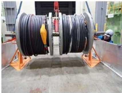
号炉間連絡予備ケーブル
