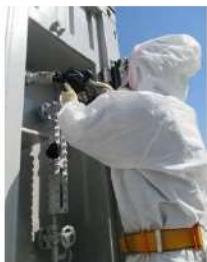
代替非常用発電機の給油口への 接続 (コネクタ接続) (代替非常用発電機) (屋外 T.P. 31m)
