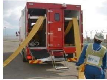
ホース延長・回収車（送水車用）による 可搬型ホース敷設 （屋外 T. P. 33. 1m）
