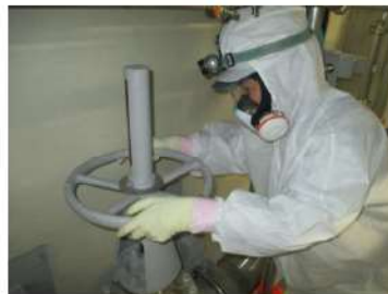
燃料取替用水ピット 水源切替系統構成 (原子炉建屋 T. P. 17.8m)
