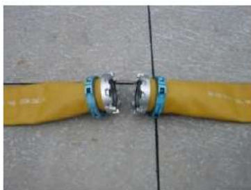
可搬型ホース (150A) 接続口
