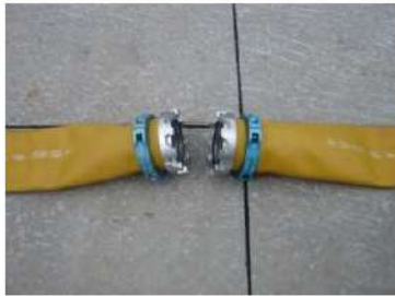
可搬型ホース (150A) 接続口
