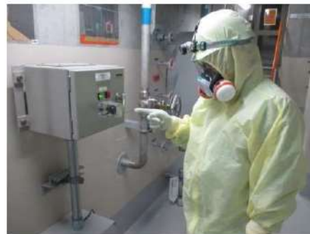
1次系補給水ポンプによる注水 (原子炉補助建屋 T.P. 17.8m)
