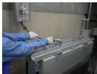
空冷配管との接続
