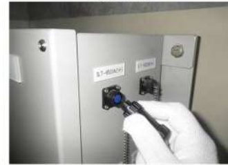
ケーブル接続 BOX
