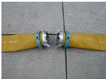
可搬型ホース（150A）接続前
