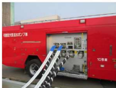
可搬型大型送水ポンプ車 周辺のホース敷設 （屋外 T. P. 33. 1m）
