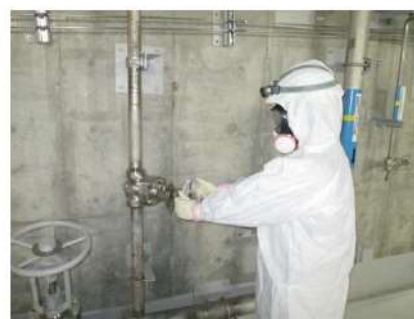
可搬型大型送水ポンプ車による原子炉格納容器下部への注水系統構成 （運転員（現場）C） （原子炉建屋 T.P. 10.3m）
