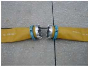
可搬型ホース（150A）接続前
