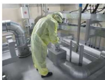
可搬型大型送水ポンプ車による 原子炉容器への注水 系統構成 （運転員（現場）B） （原子炉補助建屋 T.P. 14.5m）
