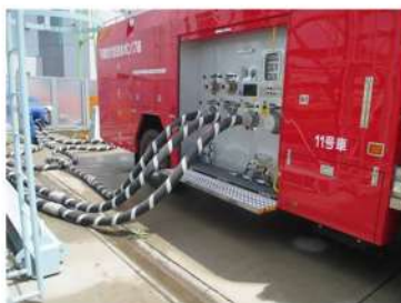
可搬型大型送水ポンプ車の設置 ポンプ車周辺のホース敷設 (屋外 T. P. 10. 3m)
