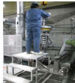
主蒸気逃がし弁開放操作(通常時) (原子炉建屋 T.P. 33.1m)
