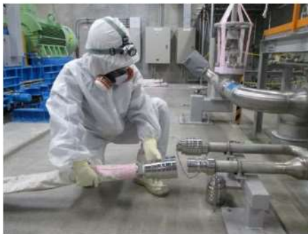
可搬型ホース接続 (原子炉建屋 T.P. 24. 8m)
