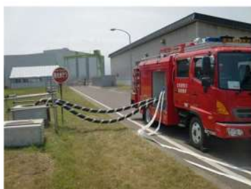
可搬型大型送水ポンプ車の設置 代替給水ピットへの吸管挿入 (屋外 T. P. 33. 1m) (作業風景は類似作業)
