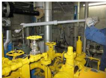
専用工具（蒸気加減弁開操作用）操作 （原子炉建屋 T. P. 10. 3m）
