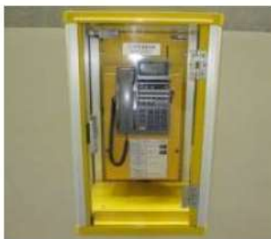
運転指令設備（警報装置を含む）
