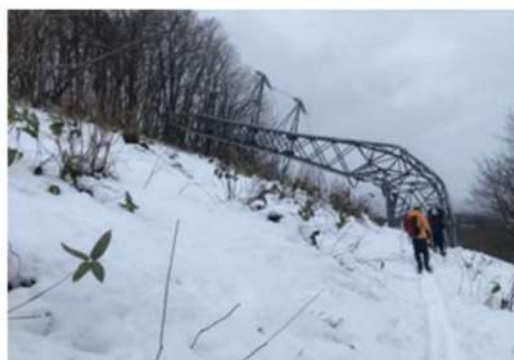
大雪による鉄塔倒壊事例 ※3
