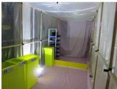
可搬型照明①
