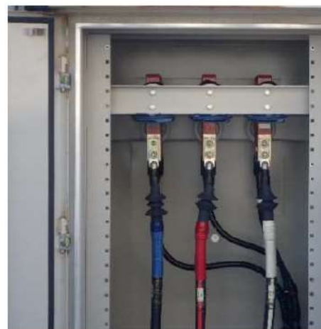
ボルト・ネジ接続 (代替交流電源)
