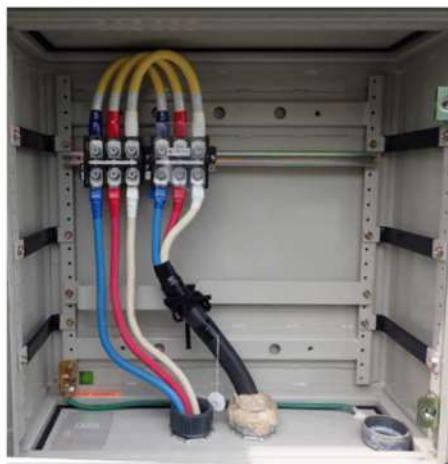
ボルト・ネジ接続 (代替直流電源)
