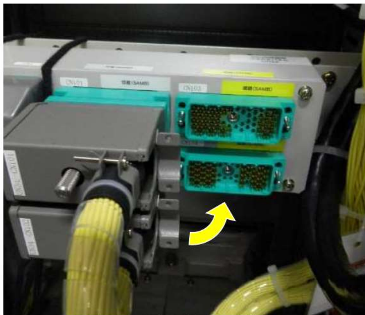
(1次系制御監視盤内 切替器)
