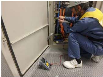
可搬型計測器接続
