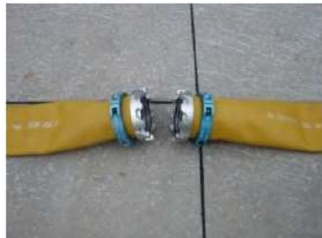
可搬型ホース（150A）接続前
