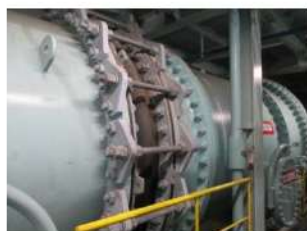
循環水管伸縮継手
