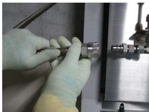
アニュラス全量排気弁等操作用可搬型 窒素ガスポンベのカプラ接続 (原子炉建屋 T.P. 40. 3m)
