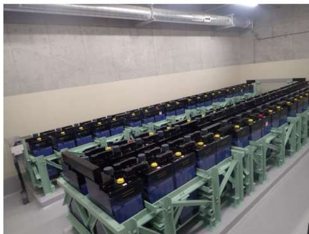
第 41-1-26 図：常用系蓄電池室の状況
