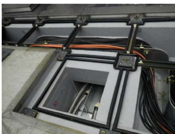
第 41-1-24 図：フロアケーブルダクトの状況
