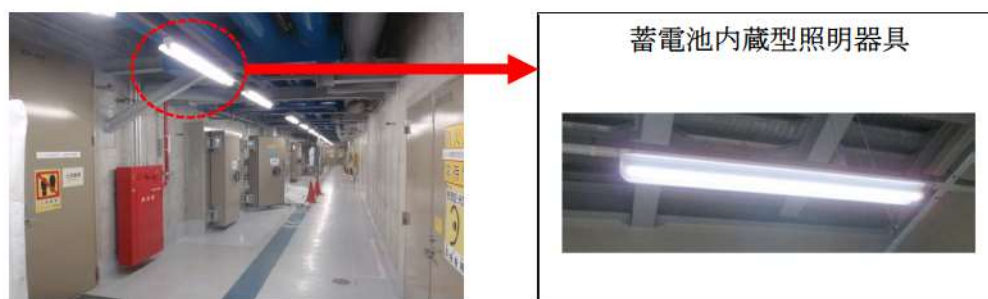
第 41-1-19 図：消火用非常用照明の設置例
