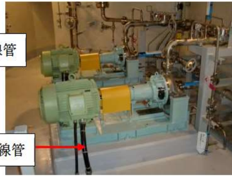
機器へのケーブル取合い状況 (格納容器冷却材ドレンポンプとの取合い)
