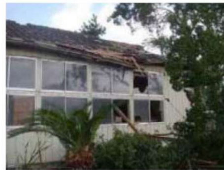
倉庫の窓ガラスと屋根の被害状況
