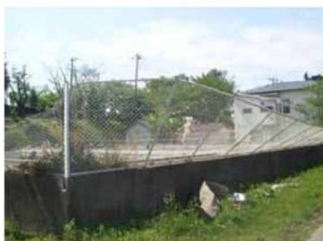
フェンスの被害状況
