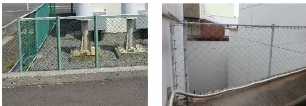
図33 泊発電所におけるフェンスの状況
