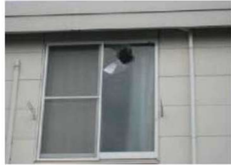
窓ガラスの飛来物衝突痕
