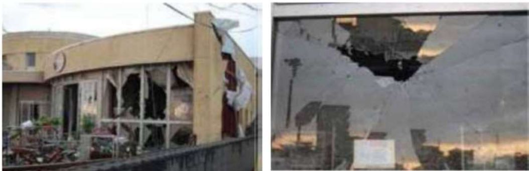
店舗の窓ガラスの被害状況
