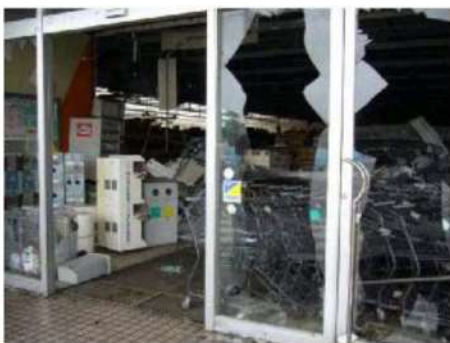
エントランスの窓ガラスの破損
