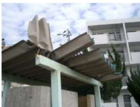
屋外トイレ屋根の損傷
