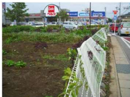
フェンスの変形
