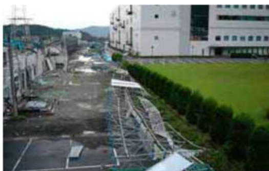
仮設足場の倒壊
