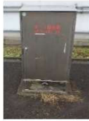
消火栓（ホース格納箱）
