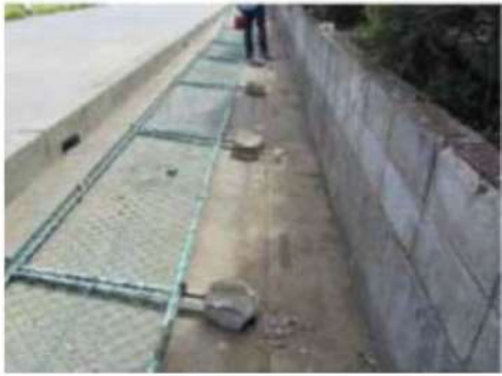
フェンスの倒壊
