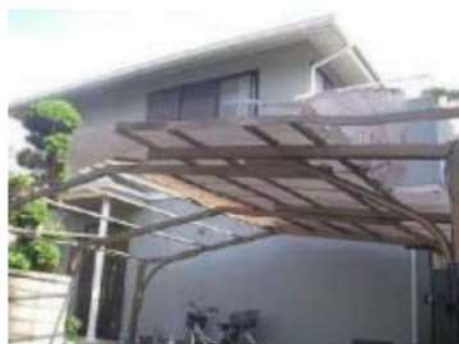
カーポートの被害
