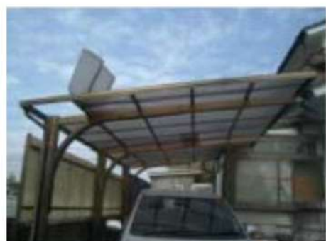
カーポート屋根の破損
