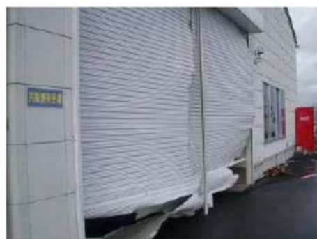
シャッターの破損
