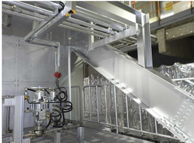
焼却炉室共通架台
