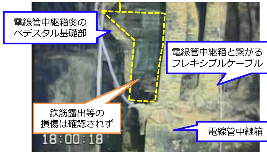
写真4. 中継箱奥ペDESTAL壁面(堆積物上部)
