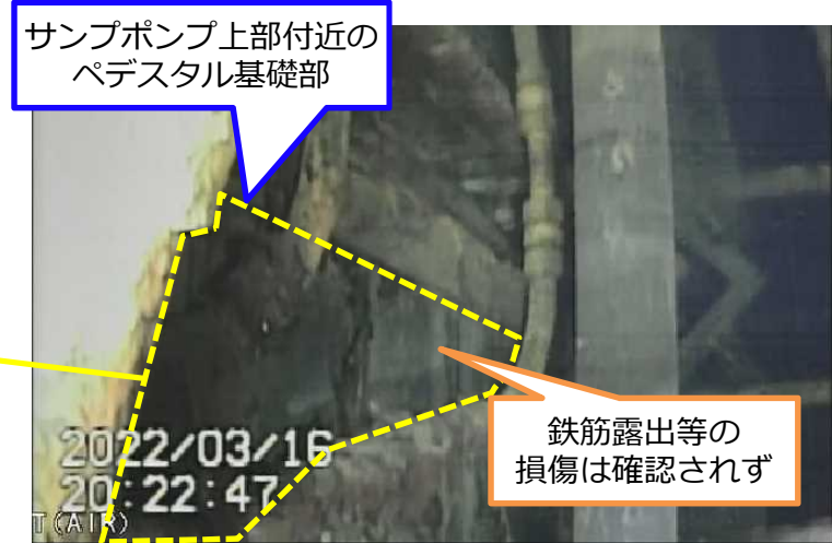
写真5. 遮へい板裏ペDESTAL壁面(堆積物上部)
