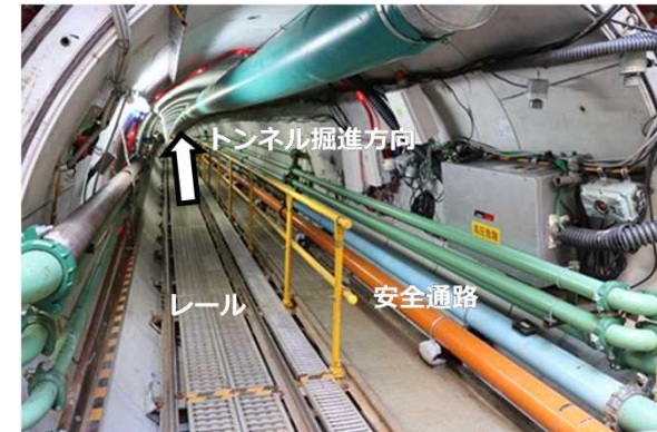
トンネル内部安全設備の整備状況
