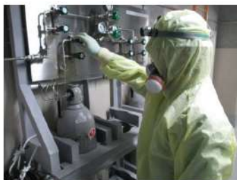
窒素供給操作(バルブパネル操作) (原子炉補助建屋 T.P. 40.3m)
