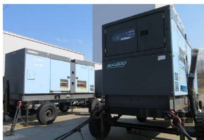
図4-11 緊急時対策所用発電機 外観
