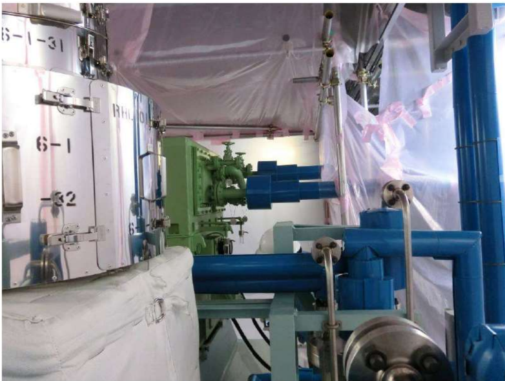
余熱除去ポンプ 周辺状況
