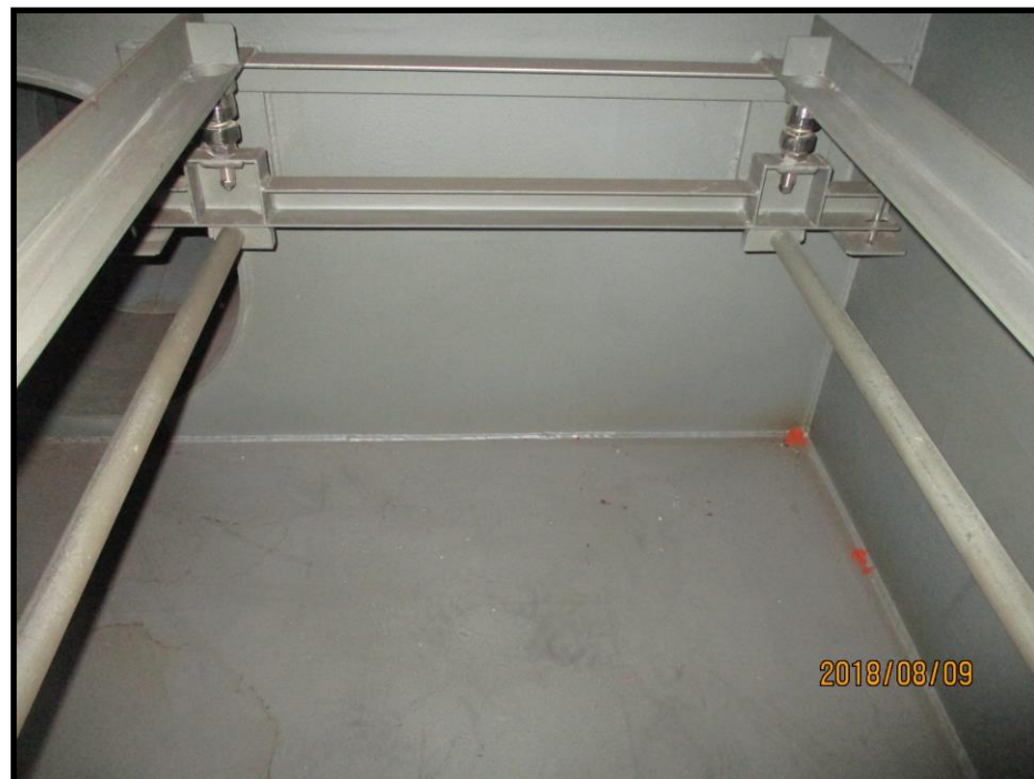
排ガスフィルター（B）内部写真
