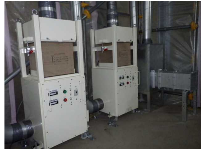
局排設備設置状況
