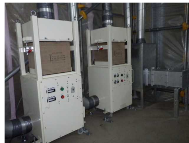
仮設局排設備の写真
