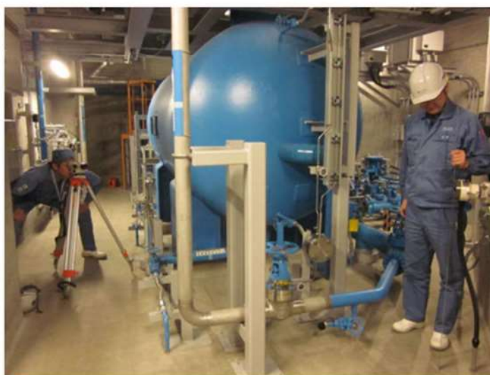
別紙1-図4 計装類 (原子炉補機冷却水サージタンク水位)
