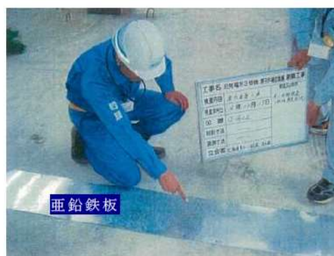
添付 1-6 図 集水管及びサブドレンの敷設状況写真 (泊発電所 3 号炉建設時)
