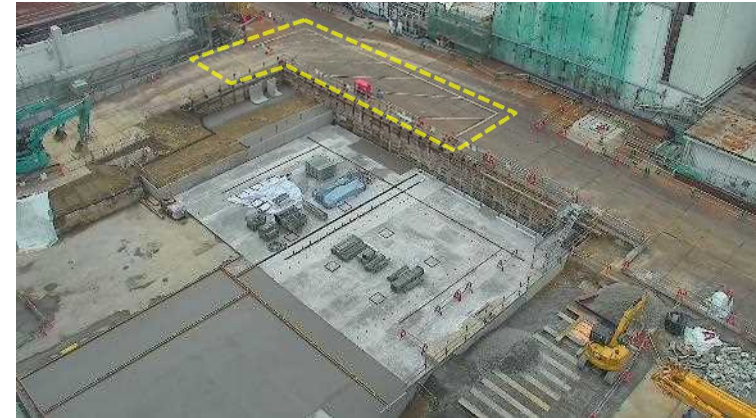
<高線量箇所テープ表示>
