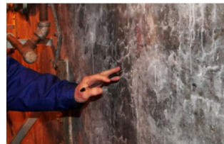
アルカリ骨材反応(遅延膨張性)の発生状況例※4
