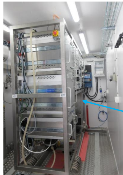
幌延町での設置とTXL室内の様子
