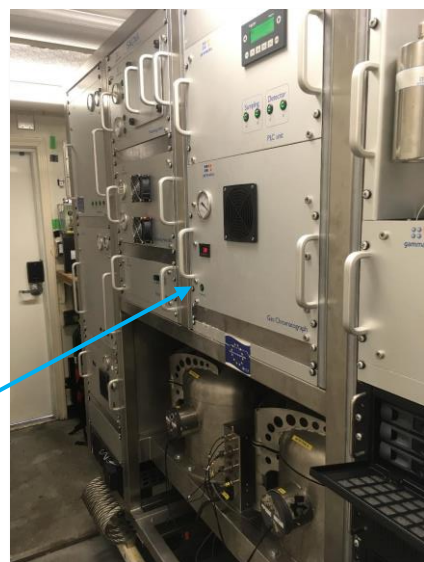
むつ市での設置とTXL室内の様子
