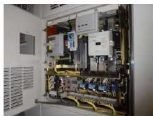
パワーコントロールセンタ
