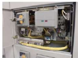
コントロールセンタ
