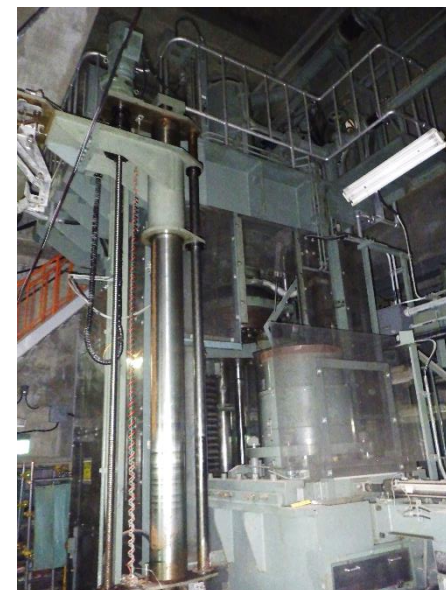
③高压圧縮機の状況
