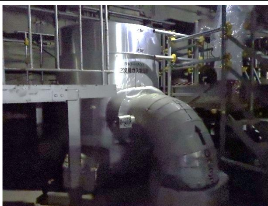
②排ガス冷却器の状況
