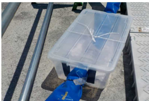
【耐圧ホース接続箇所】
