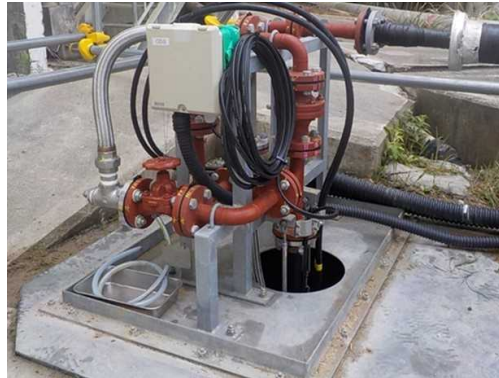
既設ユニット配管 (写真はNo.59ピット)
