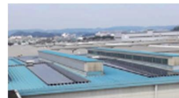
①工場屋根への太陽光パネル設置 （日産自動車追浜工場）
