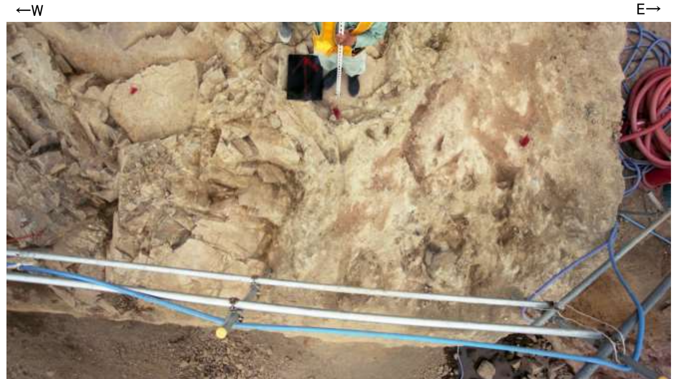
写真② 2号機地下式軽油タンク(DBA)連絡ダクト底盤 S-4端部
