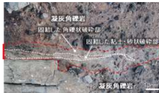
露頭における破碎部の事例
