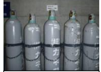
予備ポンベの配備
