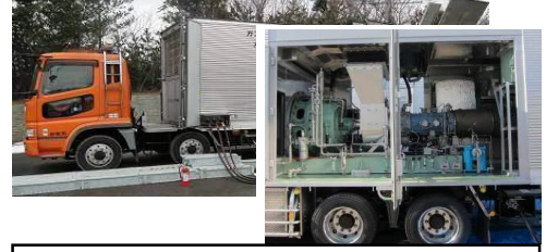
ガスタービン発電機車 (高台配備)
