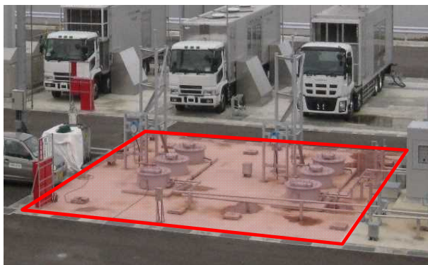
ガスタービン発電機車専用の軽油貯蔵タンク
