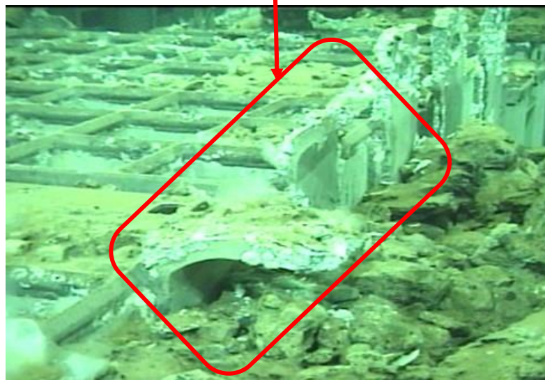
吊りピース変形
