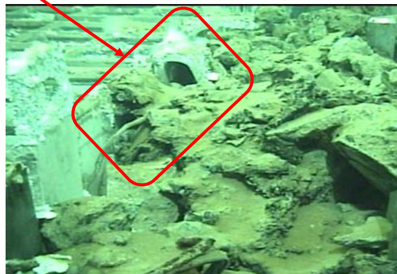
吊りピース変形
