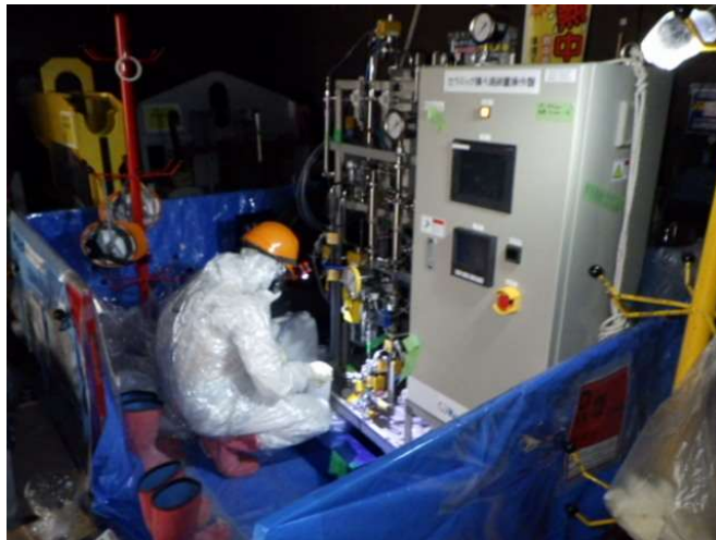
フィルタ通水試験装置写真
