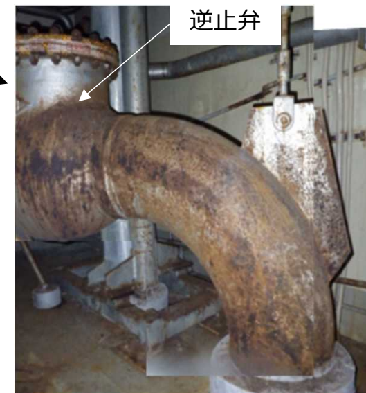
既設CUW配管
