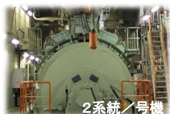
非常用ディーゼル発電機
