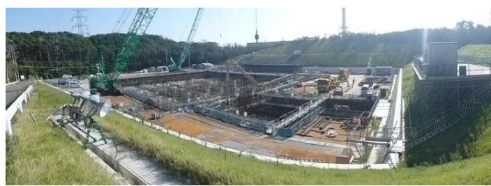
緊急時淡水貯槽
