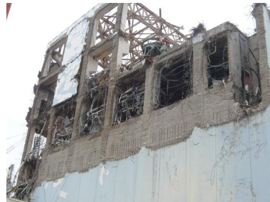
参考 4号機R/Bの損傷状況
