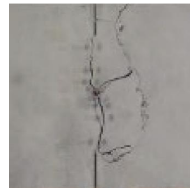
破壊状況（平面）
