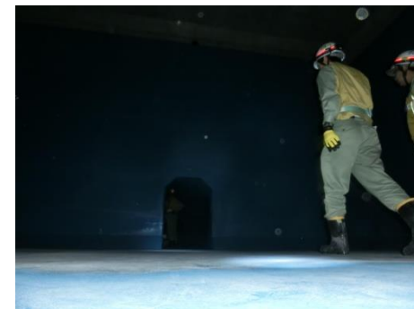
淡水貯槽内部
